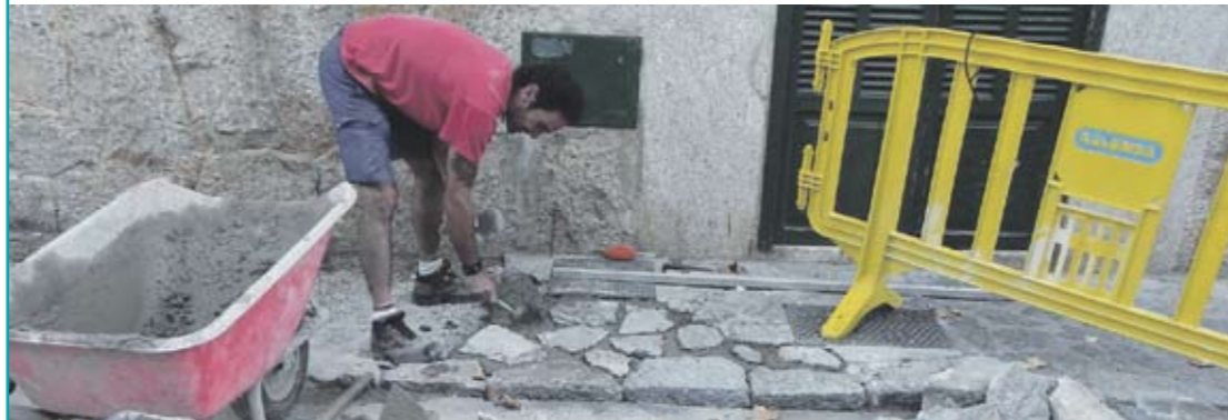
S'han arreglat molts trams de l'empedrat de les voravies que estava esbaldregat.
